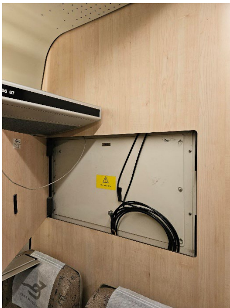
Figur 4 Antennkablage tåg mot takantenn
